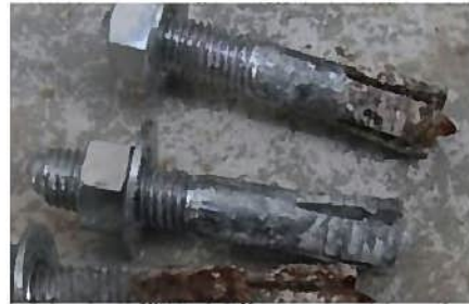
地震で抜けたアンカーボルト
